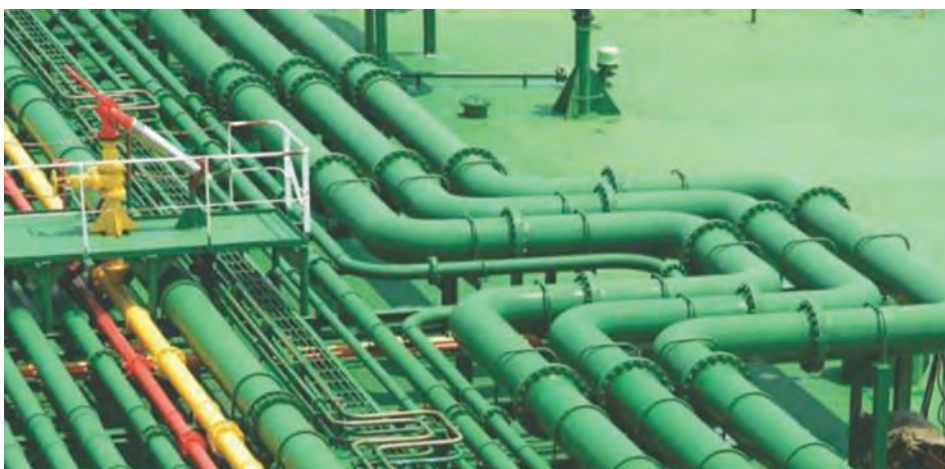
شکل ۲۹- سامانه لوله‌کشی روی عرشه یک نفتکش
