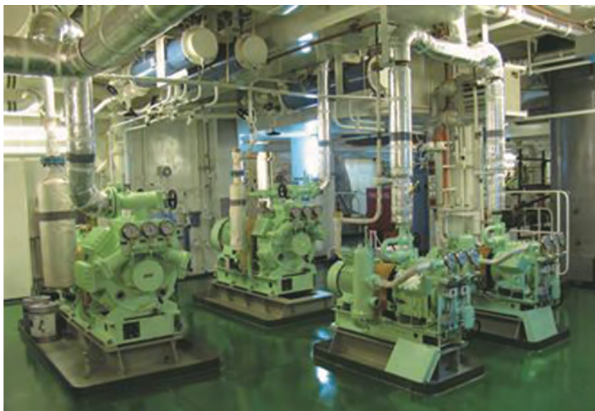
شکل ۱۹- کمپرسورهای هوا در ساختمان کشتی
