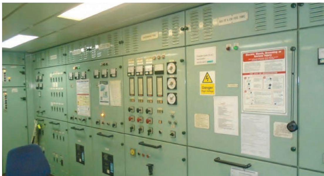
شکل ۲۳- تابلوی اصلی برق شناور
