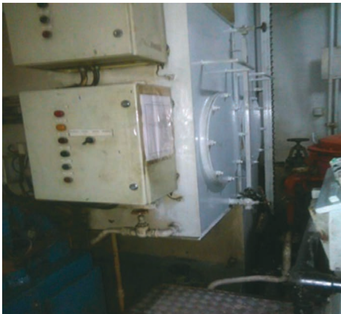
شکل ۲۳- مخزن سوخت روزانه یک شناور
