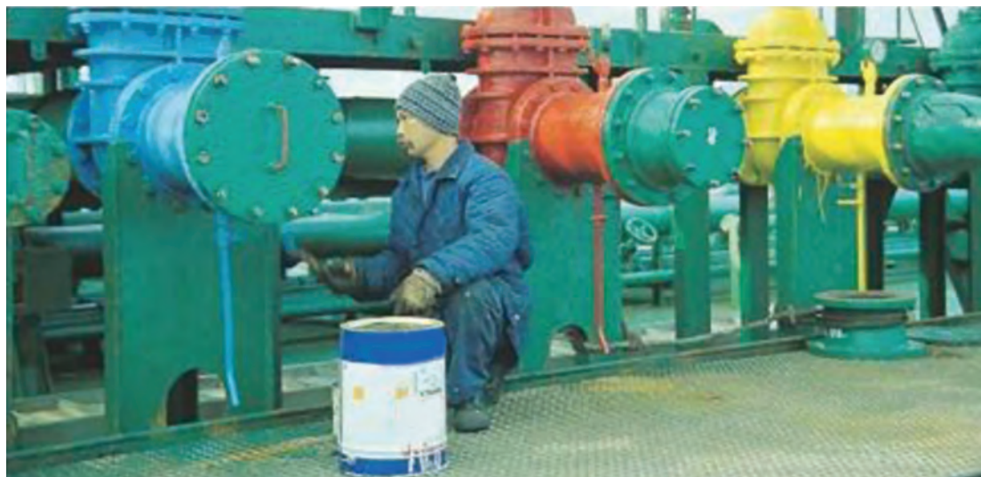
شکل ۵۵- رنگ آمیزی سامانه‌های لوله‌کشی بر روی عرشه
